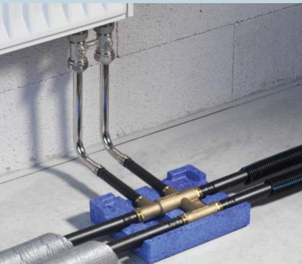
Heizkörperanbindung mit Kreuzungsfitting und Metallrohrbögen
